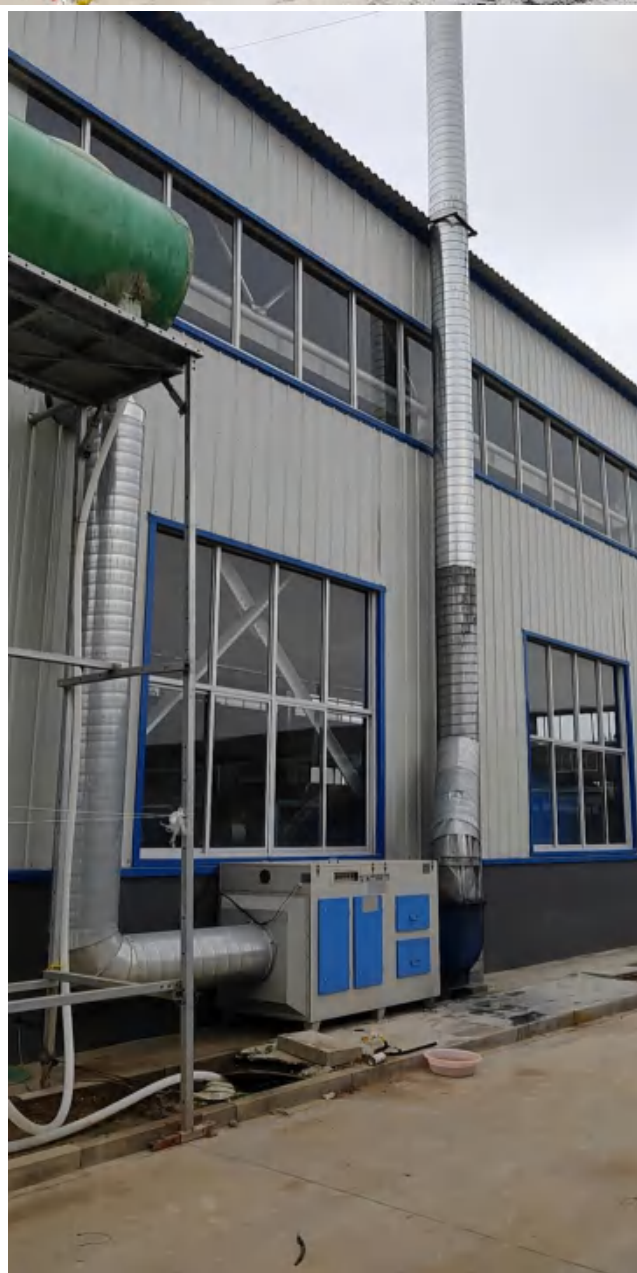
图 3-1 废气治理设施现场图
