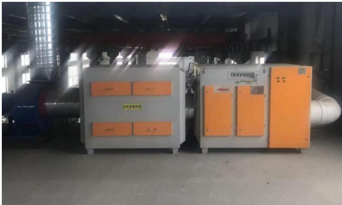
图 3-1 废气治理设施现场图
