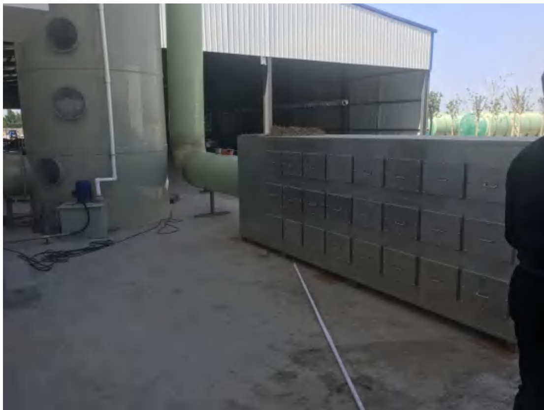
图 3-1 废气治理设施现场图
