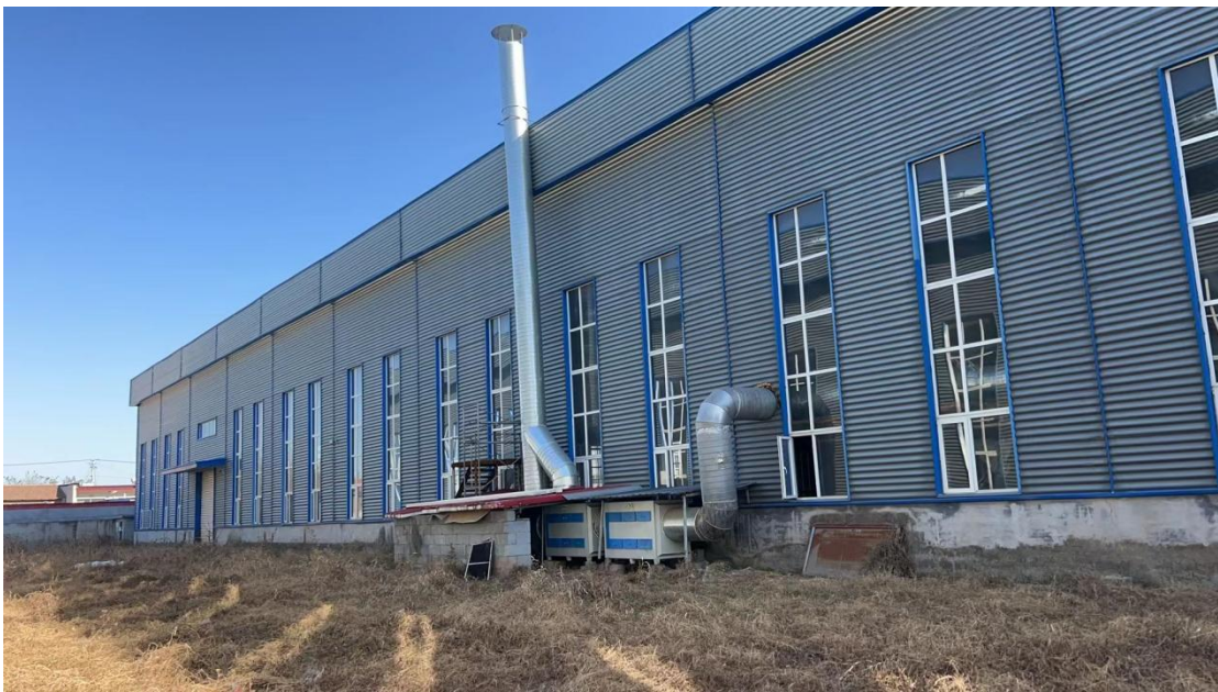
图 3-1 废气治理设施现场图
